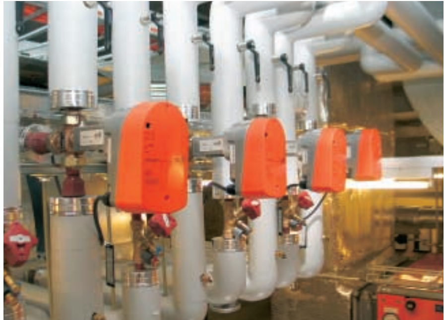
... und Belimo-Ventilantriebe am MP-Bus.
