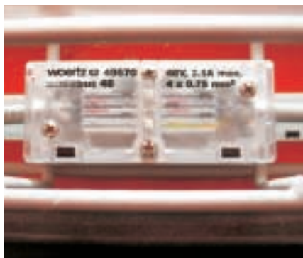
Rationelle Installation des MP-Busses mit dem 4-poligen Flachkabel von Woertz mit Durchstosstechnik.
