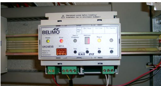
Gateway MP/EIB UK24EIB in der Hauptverteilung HV
